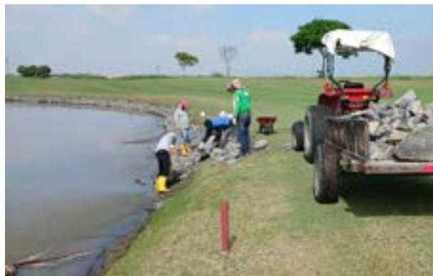
Actividad: Trabajo de enrocado en el lago del hoyo 5 Duración: 11, 12, 13, 14 y 15 de mayo
