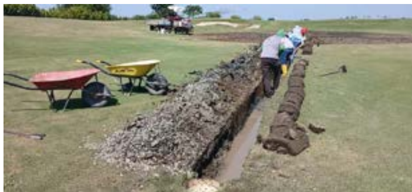
Actividad: Construcción de sumidero y cambio de tubería en hoyo 1 Duración: 18, 19, 20, 21 y 22 de mayo
