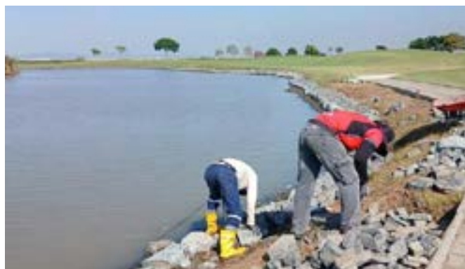
Actividad: Trabajo de enrocado en el lago del hoyo 5 Duración: 18, 19, 20, 21 y 22 de mayo
