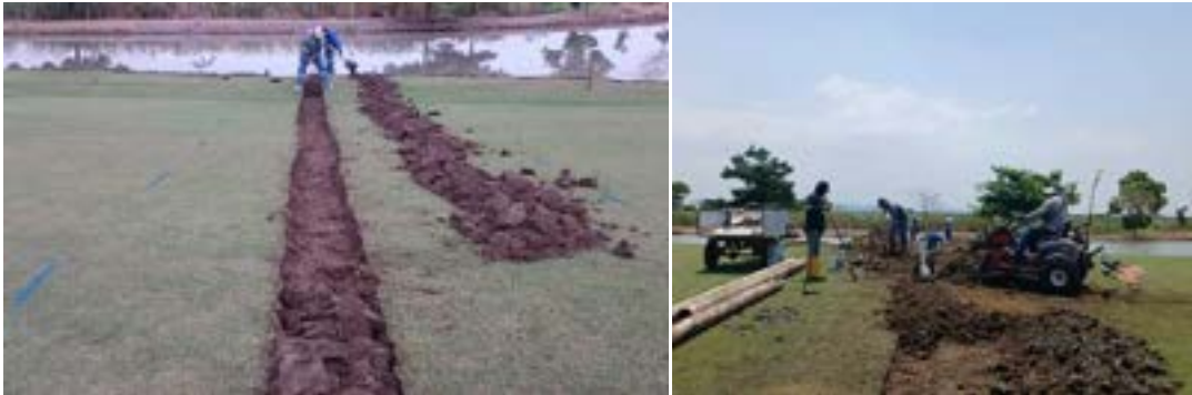
Actividad: Cambio de tubería de drenaje en hoyo 7 Duración: 08, 09 y 10 de abril
